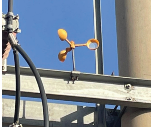
Зураг 16. Дэд станцуудын хөндлөв хэсгүүдэд тольтой шувуу үргээгч суурилуулсан байдал
