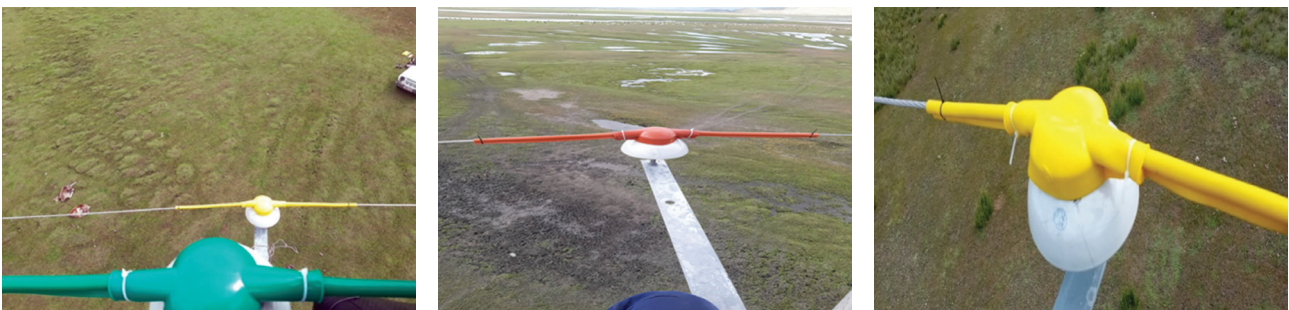
Зураг 23. Сайн туршлага. 110/35/10кВ-ын Баруунхараа дэд станцын Яч№17 10кВ-н Сүмбэр АШ-ын тулгуур №1-240-н хооронд Р-15 тусгаарлагчид 672 ширхэг тусгаарлагчтай бүрхүүл, АС дамжуулагч утсанд 403 метр шувуу хамгаалах дамжуулагч утасны тусгаарлагч
